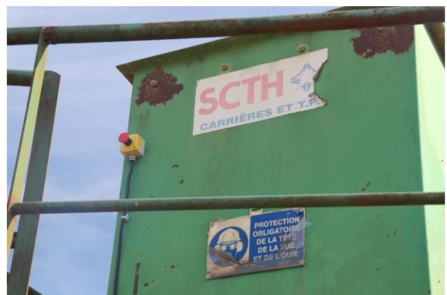
Exemple d'arrêt d'urgence sur l'installation
