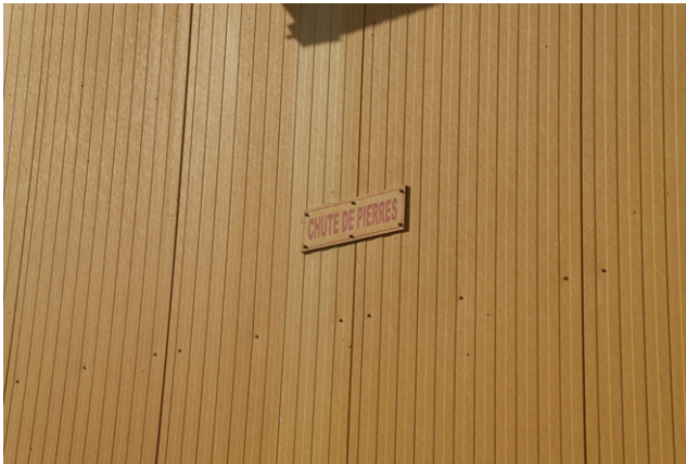
Risque de chutes de matériaux
