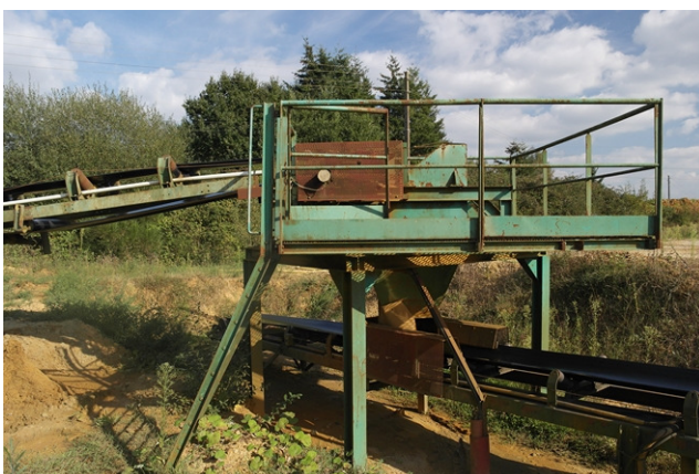
Protection du tambour de tête sur convoyeur
