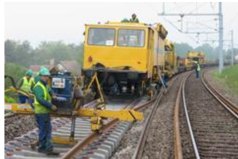
Longs Rails soudés sur traverses béton
