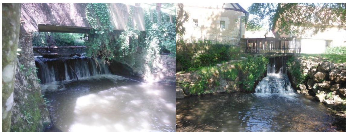
Figure 112 : Situations dégradées – Source : Hardy Environnement
