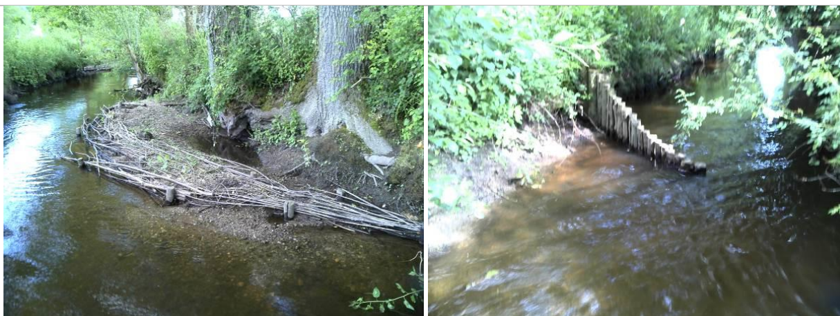
Risbermes et épis mis en place sur un cours d'eau du bassin versant du Trévelo – Source : Hardy Environnement
